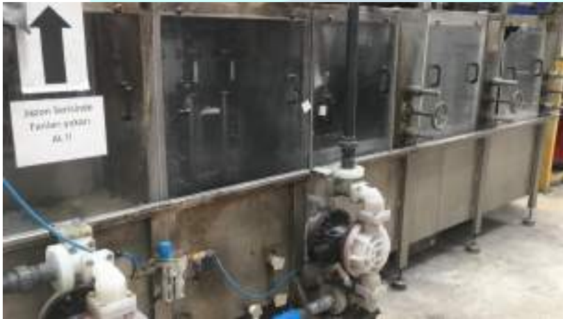
Şekil 28. Akü Yıkama Makinesi
